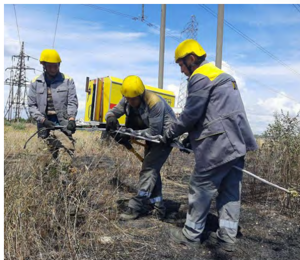
■ Figure 1 : Lignards de la compagnie DTEK réparant une ligne 150 kV après le bombardement de Kherson en août 2023 (source DTEK).
