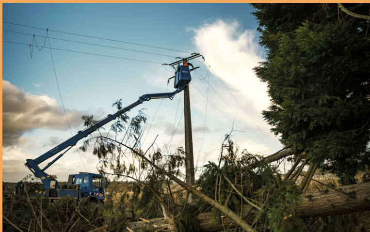
Les équipes d'Enedis à pied d'œuvre pour dépanner le réseau HTA détruit après le passage de la tempête Ciaran en novembre 2023.
