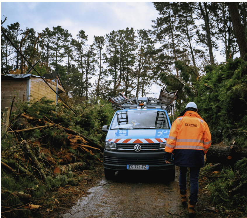
Figure 2 : En 2023, plus de 3500 salariés d'Enedis ont été mobilisés durant plusieurs jours dans le dispositif FIRE, pour rétablir les clients coupés en Bretagne et Normandie.
