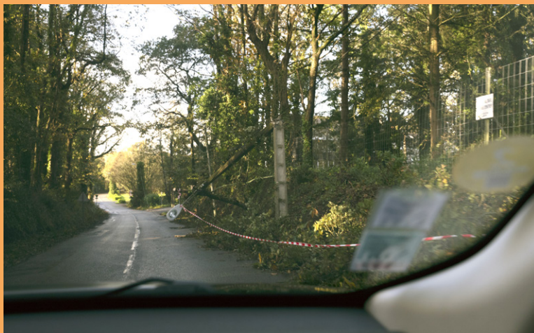
■ Poteau béton et ouvrages d'éclairage publics détruits suite au passage de la tempête Ciaran en novembre 2023.
