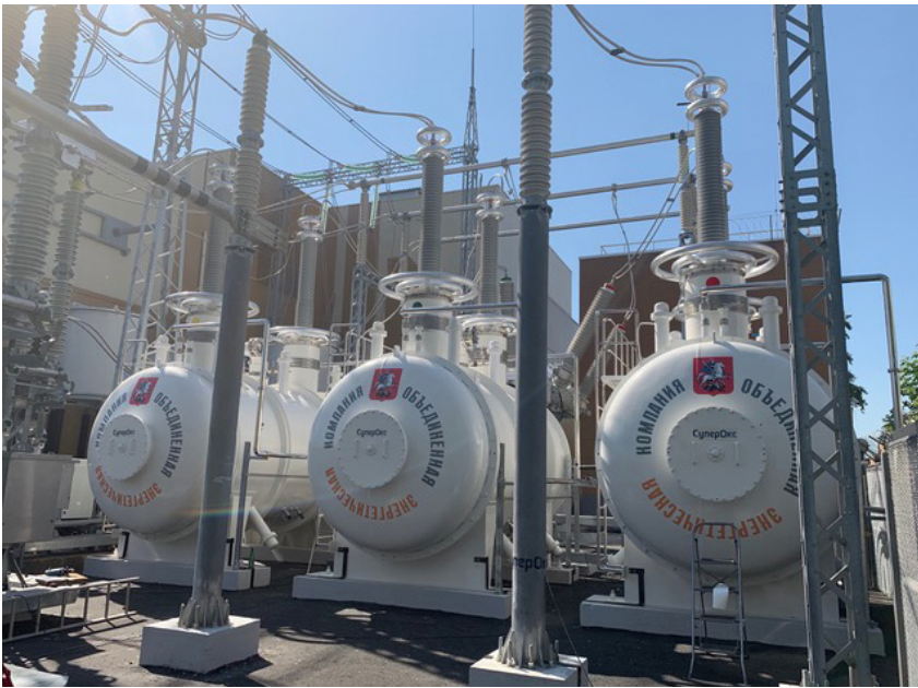
Figure 8 : Limiteur de courant de défaut 220 kV / 2,4 kA SuperOx installé à Moscou (Russie).
