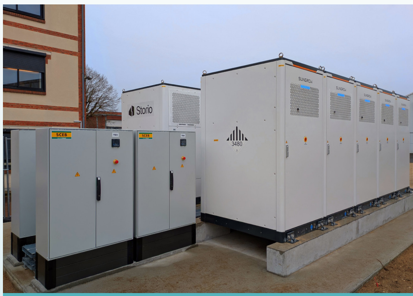
Figure 1 : Système de stockage Storio par batteries d'une capacité de 2,5 MWh déployé sur le site du siège de Baudin Chateaufort. Couplé à des panneaux solaires, le système permet de subvenir à 50 % des besoins du site.
