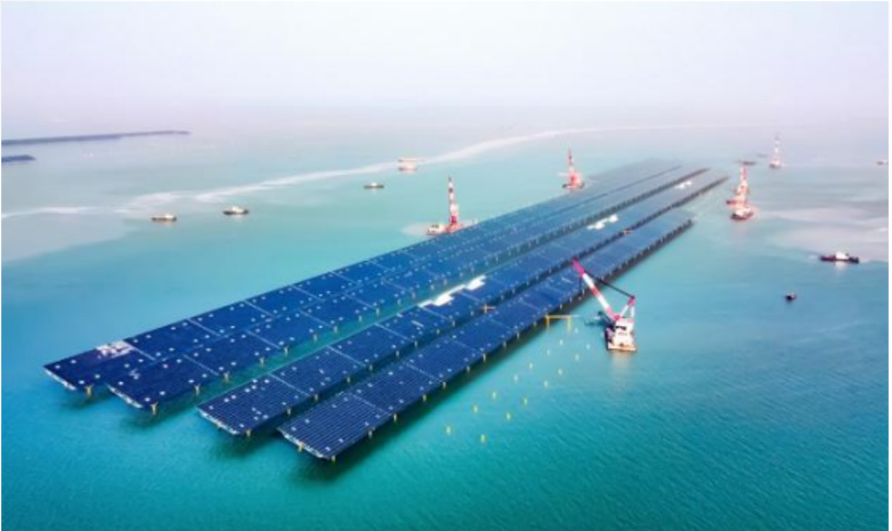
Figure 2 : Une centrale solaire flottante de 1000 MW, mise en service en 2024 dans le Shandong.
