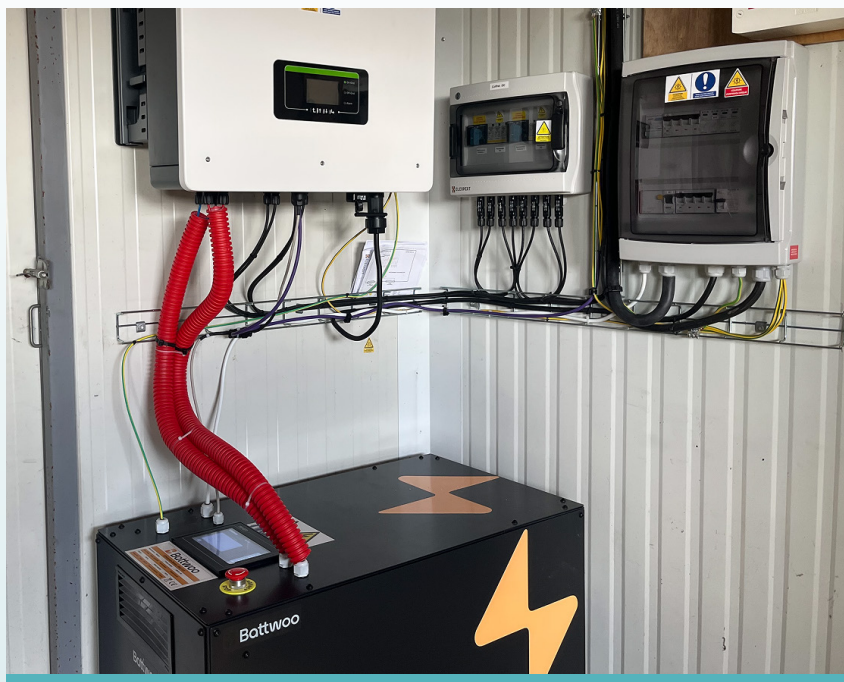
Figure 1 : Unité de stockage stationnaire de 35 kWh, jumelée à une centrale solaire au sol, avec un chargeur de véhicule électrique en output. Installation réalisée par Aty Solar.
