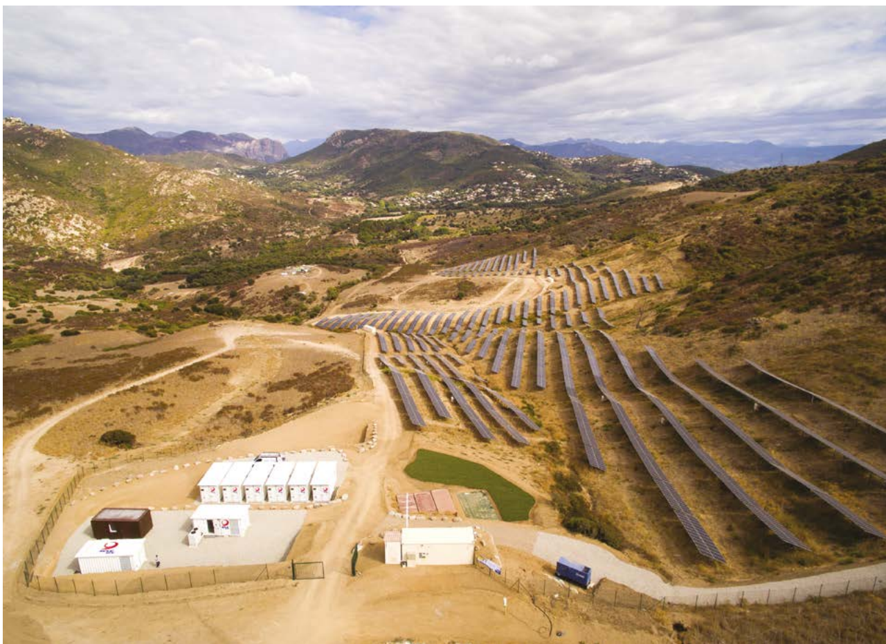
Photo 1 : Centrale photovoltaïque avec stockage de 7 MW et 7 MWh à Mortella (Corse) – © : SCLE-SFE
