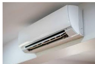
Figure 4 : Unité intérieure de PAC air/air.
