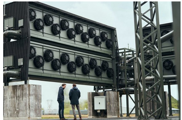
■ Installation de captage de CO 2 à l'usine d'Orka, Islande. © Climeworks.
